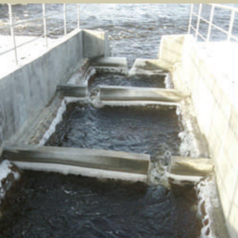
Przepławka techniczna - szczelinowa.
