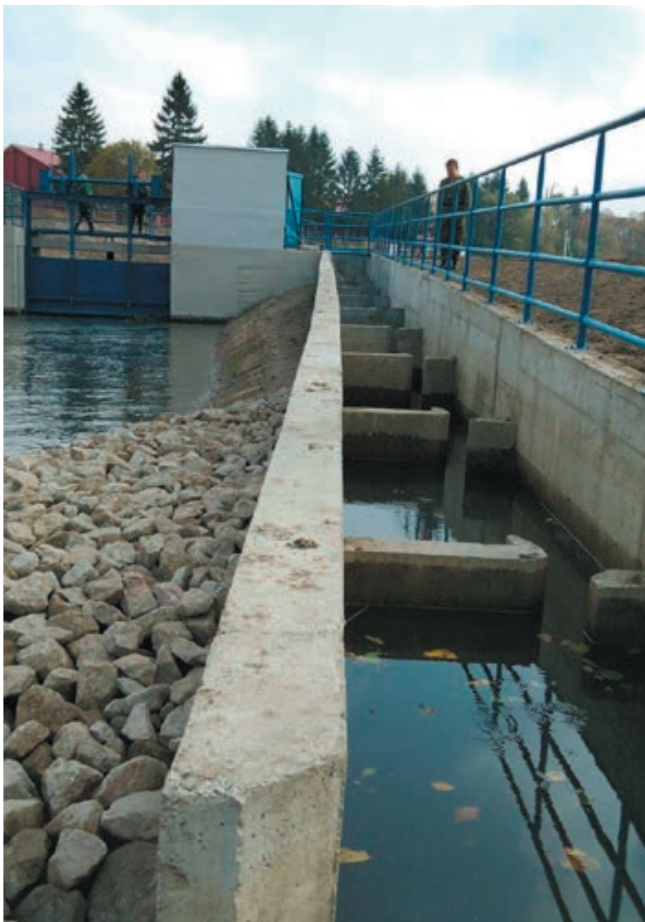
Przepławka techniczna typu Verticl Slot-Pass na Dzierżęcince w Koszalinie.
